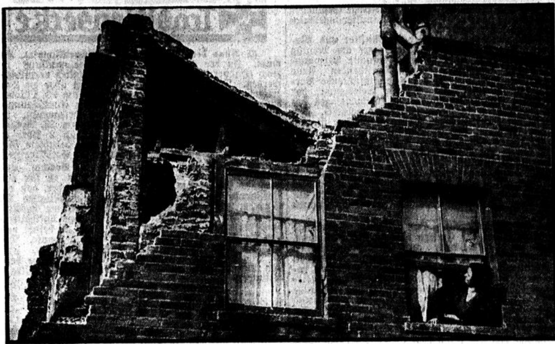
Nach den letzten Berichten hat der Sturm, der mit einer Geschwindigkeit bis zu 107 km in der Stunde über Südbengland wütete, etwa zwanzig Todesopfer gefordert. In London wurden zahlreiche Häuser abgedeckt. Unser Bild zeigt ein Haus in der Londoner Wall Street, dessen Mauer durch den Sturm umgerissen wurde.
