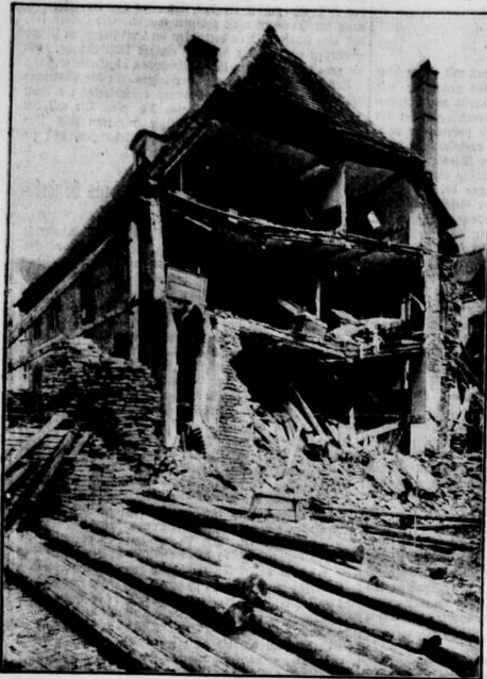
In Wm stürzte ein im Umbau befindliches Haus, das bereits vollständig abgenommen war, aus unbekannten Ursachen ein. Glücklicherweise waren die Arbeiter bereits vom Bau nach Hause gegangen und auch die Bewohner, soweit sie sich noch in dem Hause aufhielten, waren zur Stunde des Unglücks abwesend. Unsere Aufnahme zeigt das eingestürzte Haus. Man erkennt deutlich, wie schweres Unglück entstanden wäre, wenn nicht durch glücklichen Zufall keine Personen in der Nähe gewesen wären.
