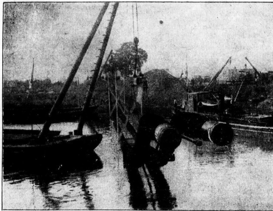
Ferngasleitung durch Ruhr und Wupper
