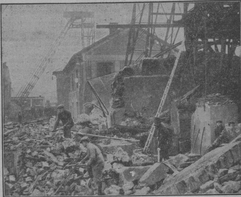
Das Trümmerfeld am Fördersturm des Nelson-Schachtes.
