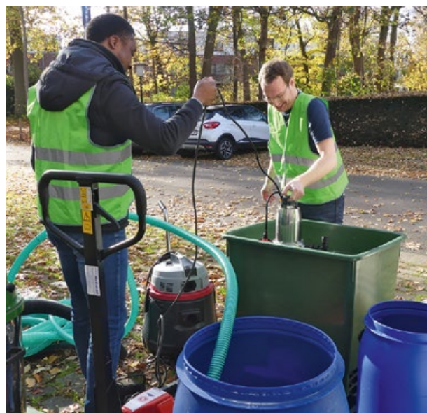
Abb. 17: Test der Schmutzwassertauchpumpe (Foto: LWL-Archivamt)
