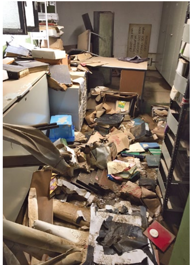
Abb. 1: ‚Archiv unter‘: Zerstörungen im Stadtarchiv Leichlingen nach der Flut vom Juli 2021 (Foto: LVR-AFZ)
